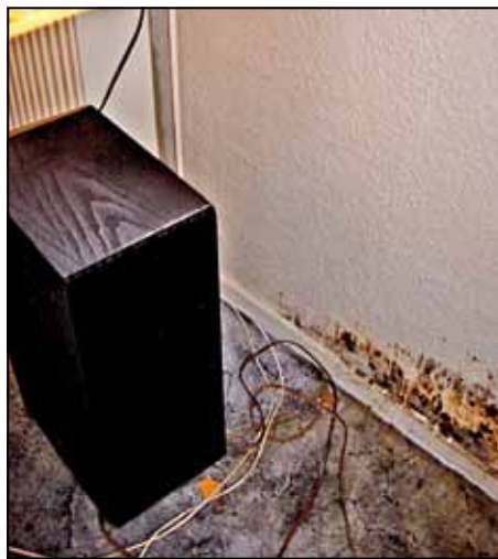
Stockflecken mit Schimmelbildung hinter dem Mobiliar.
